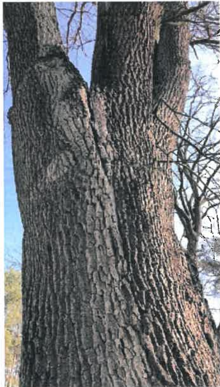
FOT. 1.3. W NASADZIE KORONY WIDOCZNE PĘKNIĘCIE. ZNAJDUJE SIĘ ONO POMIĘDZY JEDNYM Z GŁÓWNYCH PRZEWODNIKÓW, A TYLCEM PO UTRACONYM PRZEWODNIKU.
